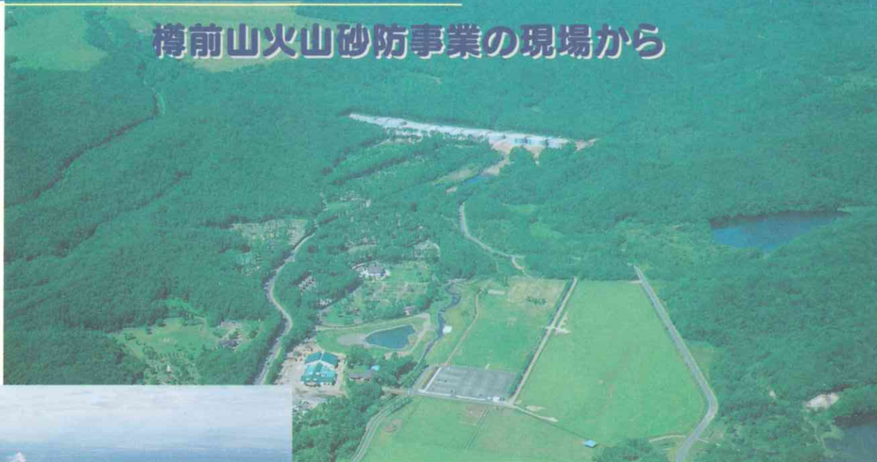
広大な森林を抱く樽前山。 中央に建設が進む覚生川3号遊砂地のダムが見える
