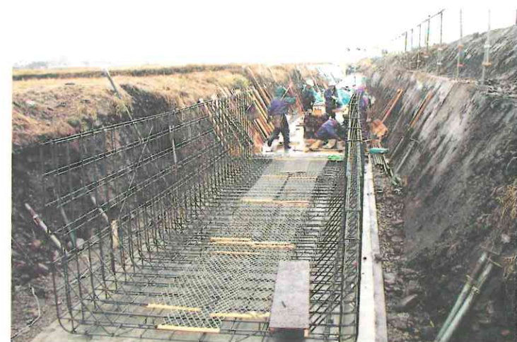
古い用水路を基礎としてその上に新しい用水路を置く形で工事をします。そうすると、古い用水路を撤去することがなく、経済的です。
