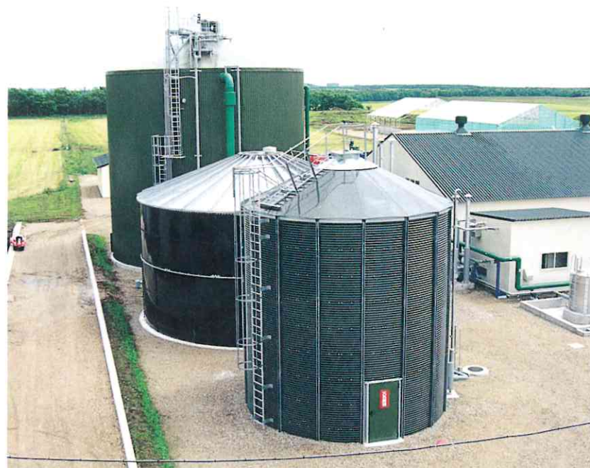
バイオガスプラント
