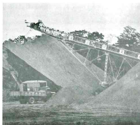
中春別に建設された碎石プラント※
