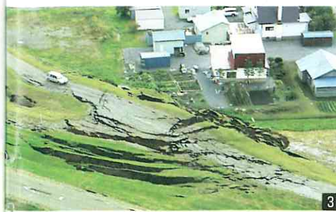
いくつもの大きな亀裂が入った堤防(十勝川 大津築堤)
