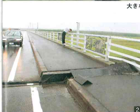
約70cmずれた橋げた(一般国道336号 十勝河口橋)
