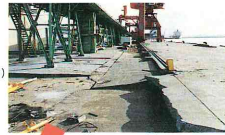
釧路沖地震後（平成5年1月） 岸壁の舗装部分が、全延長にわたり大きく沈下するなどの被害を受けました
