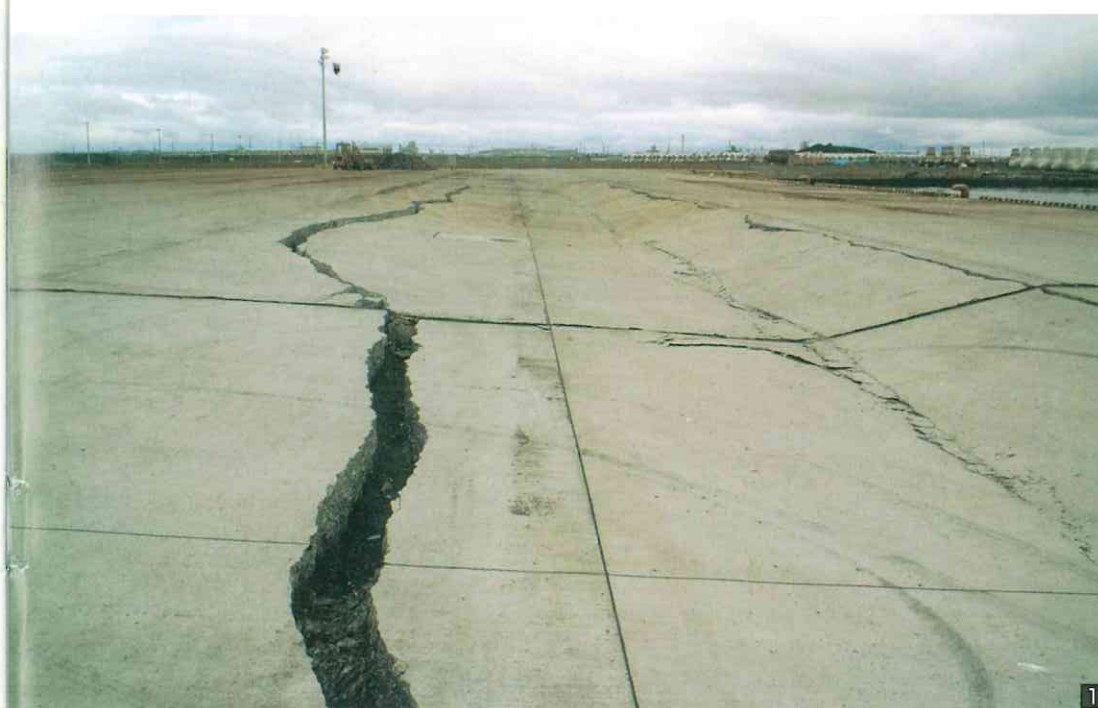
大きな亀裂、沈下が発生した岸壁(釧路港 西港地区第4ふ頭岸壁-10m)
