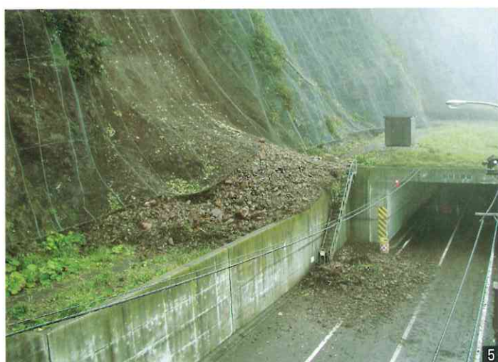
斜面崩壊により通行止めとなった国道(一般国道336号 広尾町タン子ソ)
