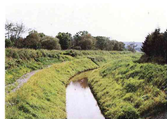
周辺の自然環境に配慮した排水路
