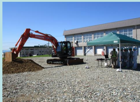
ICT建機のデモも見学しました
