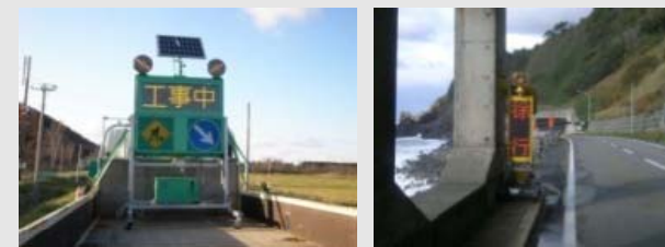
(ソーラー式安全標識稼働状況)
