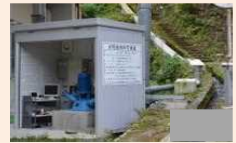
小水力発電設備
