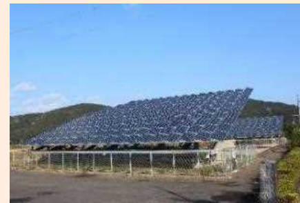
太陽光発電設備
