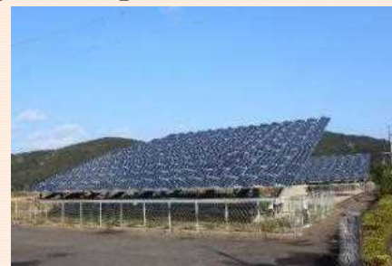
太陽光発電設備
