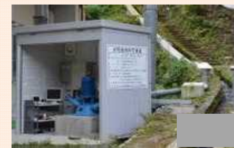
小水力発電設備
