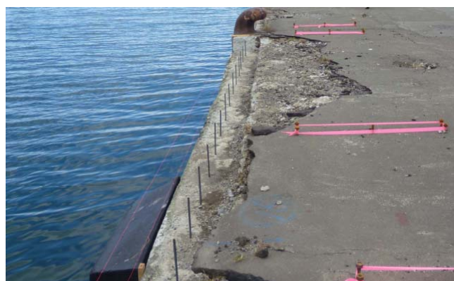
技術的監査（車止めの欠落）
