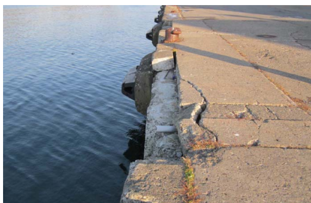
技術的監査（上部工の損傷）
