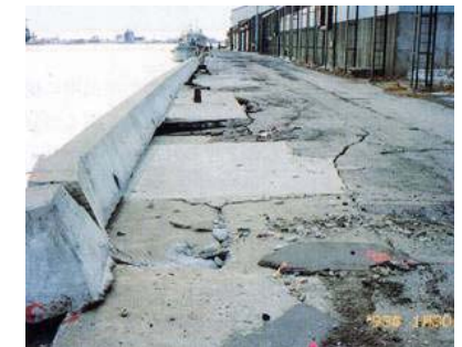
釧路沖地震による被害状況(釧路湾) 災害発生 H5.1.15
