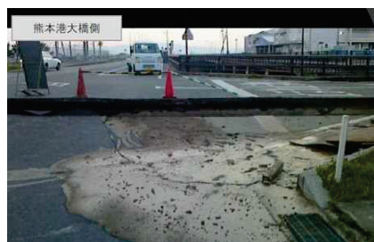
垂直方向に変位している段差 (H28熊本地震/熊本港)
