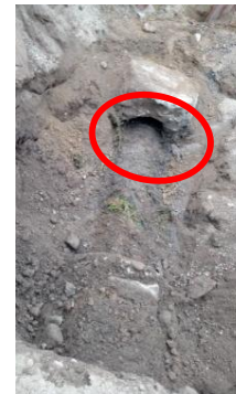
横断水路継ぎ目部に隙間が発生
