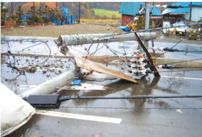
▲竜巻による電柱の倒壊 (H18.11 佐呂間町 国道333号)
