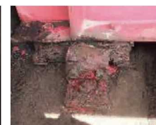
支承腐食：上部構造と下部構造の接合部が腐食している状態
