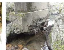
橋脚洗掘：橋脚周辺の土砂が流水により洗い流され消失した状態
