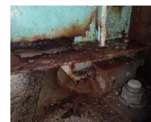
主桁腐食：上部構造から垂直方向に働く荷重を下部構造に伝える桁が腐食している状態
