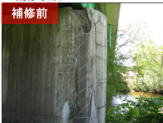
橋脚の損傷(剥離・鉄筋露出、うき)
