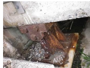
老朽化による橋脚、支承等の損傷
