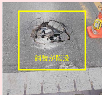
床版の損傷が深刻化、舗装が陥没
