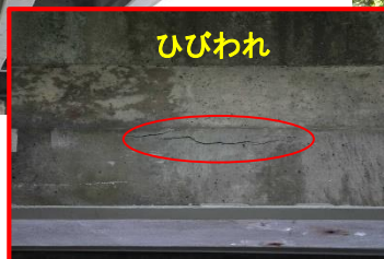
主桁の塩害による損傷
