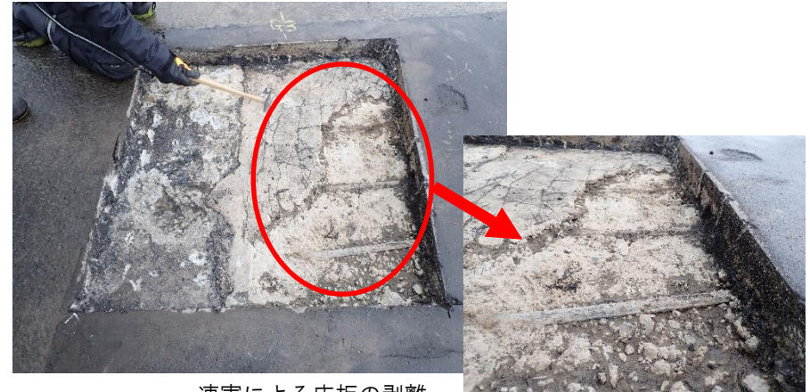
凍害による床板の剥離
