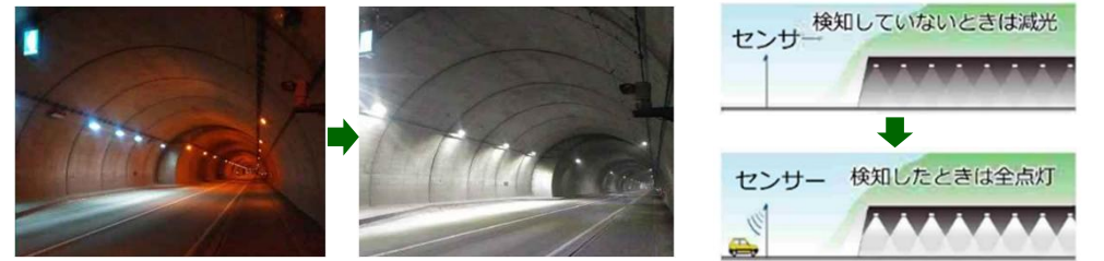
《道路照明設置間隔見直し事例》 (国道230号洞爺湖町 三豊トンネル)
