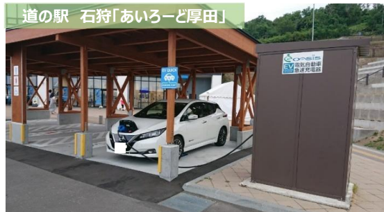
《「道の駅」でのEV充電状況》
