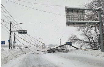
▲暴風雪による電柱倒壊 (R4.12.23 国道38号 幕別町)
