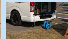
電源設備の使用風景
