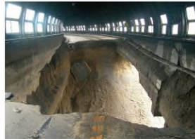
【三国の沢覆道損傷】
