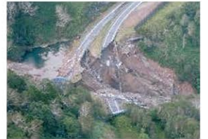
【帯広側8号目付近盛土崩壊】
