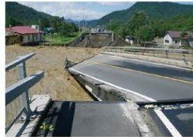
【千呂露橋落橋】
