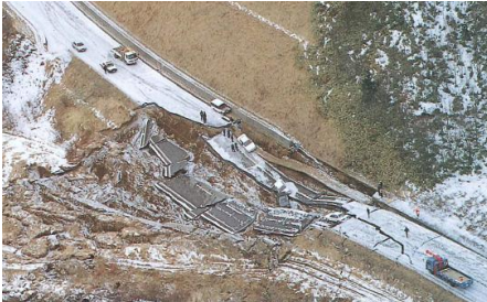
▼国道の被害状況(H5釧路沖地震)
