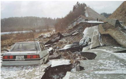
▼国道の被害状況(H5釧路沖地震)
