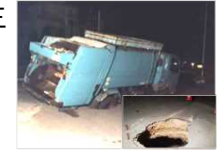
下水道の老朽化による道路陥没
