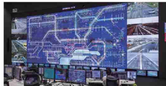
関東支社道路管制センター(交通管制部門)
