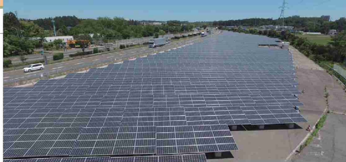
仙台太陽光発電所
