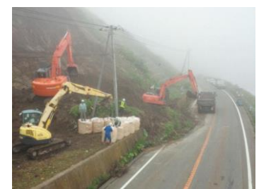
土砂崩れによる通行止め状況 (H23.7.16) (新ひだか町 幌舞)
