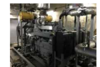
＜自家発電装置＞
