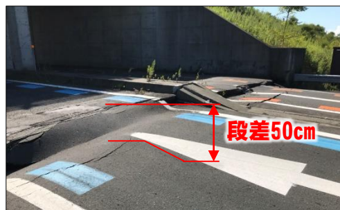
被災状況 ～路面が沈下～
