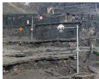
国道230号に断層が発生
