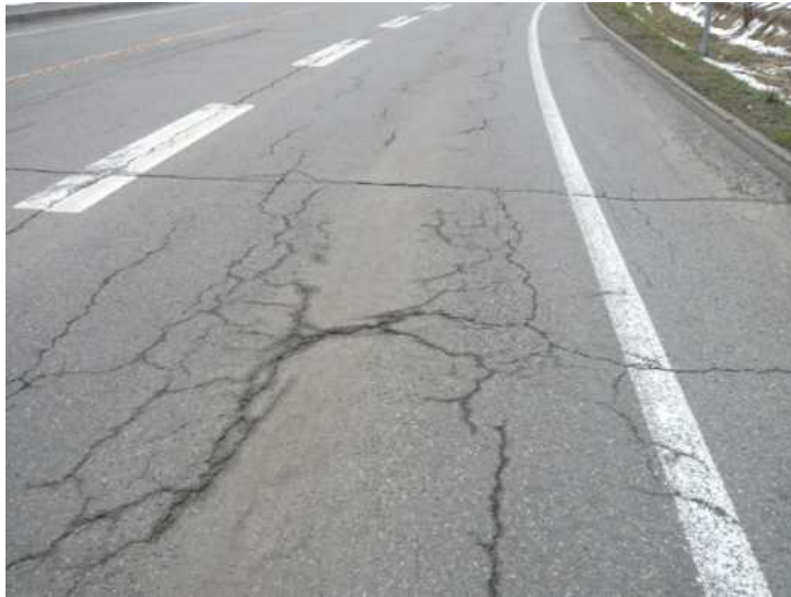
路面クラック
