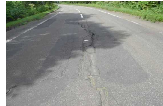
クラック損傷
