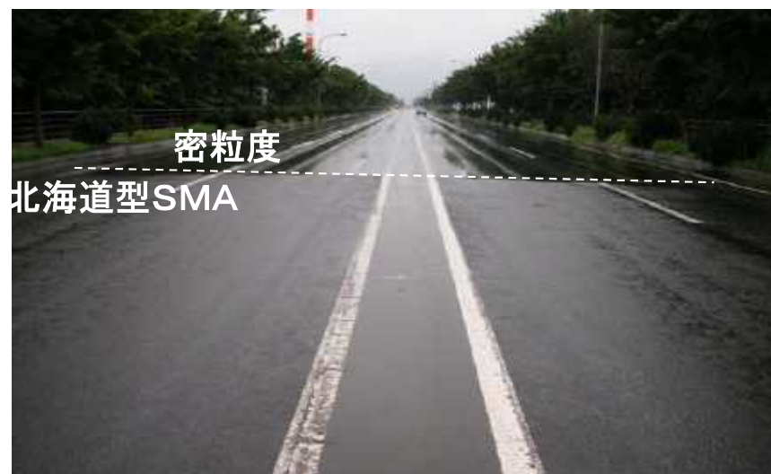
雨天時の路面状況
