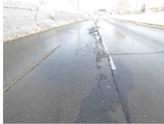
縦打継目部の損傷例
