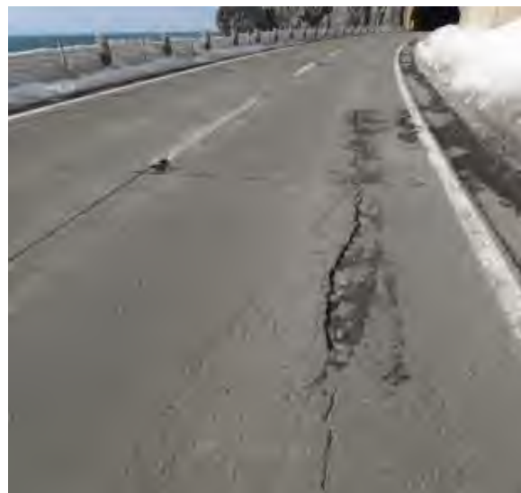
写真-1 縦断ひび割れの例
