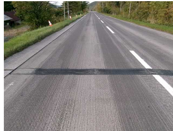
横断クラック(5m付近 シートで処理)
