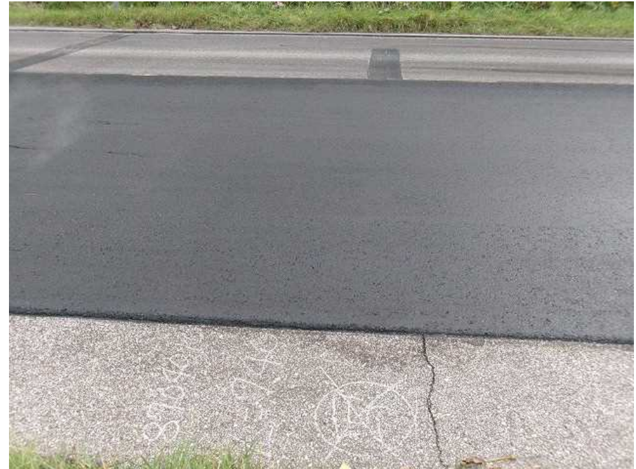
横断クラック上のシナヤカファルト 起点から40m付近)
