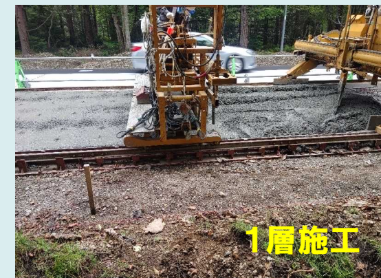
鉄網・縁部補強鉄筋の設置なし(1層施工)
