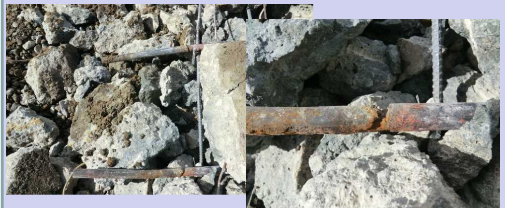
ダウエルバーの腐食・破断
