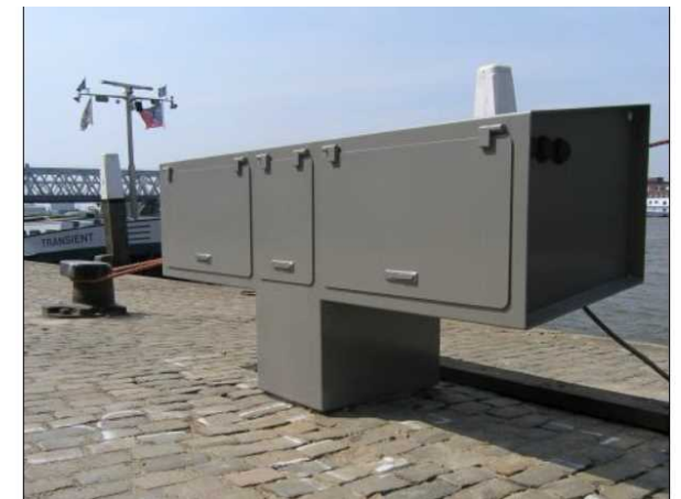
浸水しない高さにある電気供給施設※1
