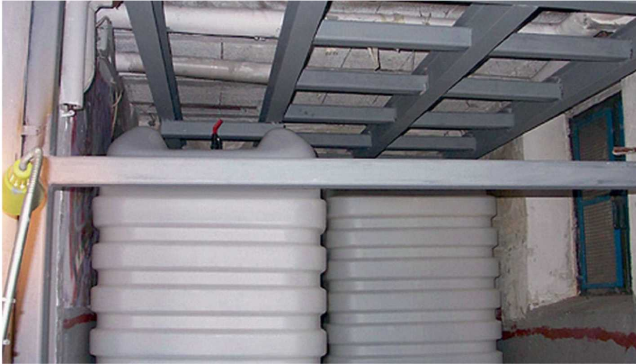
浮力安全装置付き暖房用燃料タンク
