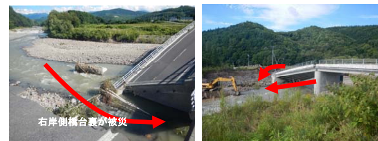
辺別川九線橋の被災(H28.8出水)
