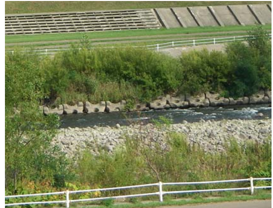
写真 4-4 根固工が露出して樹林化が進行
