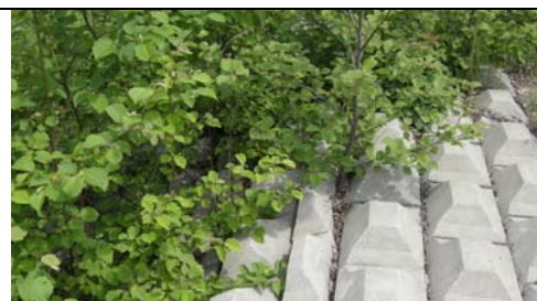
連節ブロック隙間からの樹林化状況
