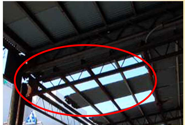
老朽化による崩壊の危険のあるアーケード
