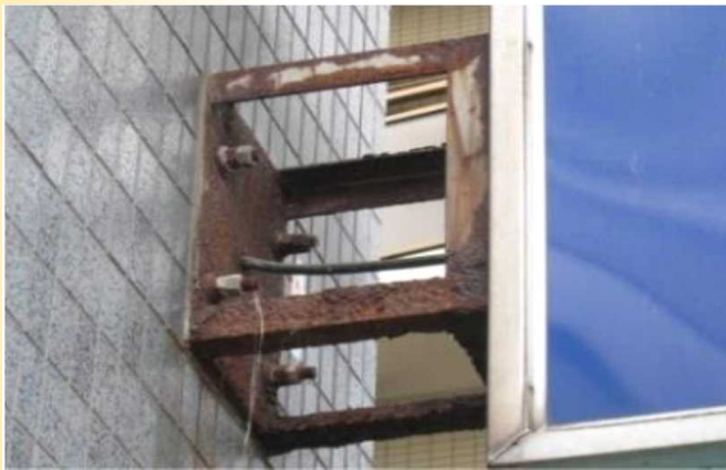
ブラケットの腐食による落下の危険のある看板 (国土交通省HPより)
