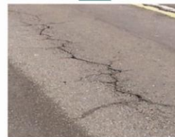
●舗装のひび割れの様子。
