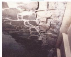
●橋が壊れている様子。
