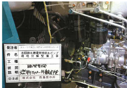
写真：本郷排水機（自家発電機 燃料フィルター点検）（大空町提供）
