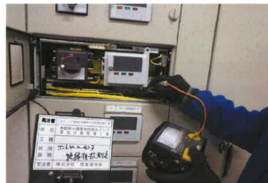
写真：本郷排水機（コントロールセンタ 絶縁抵抗測定）（大空町提供）
