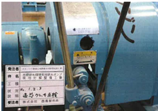
写真：本郷排水機（主エンジン 遠心クラッチ点検）（大空町提供）
