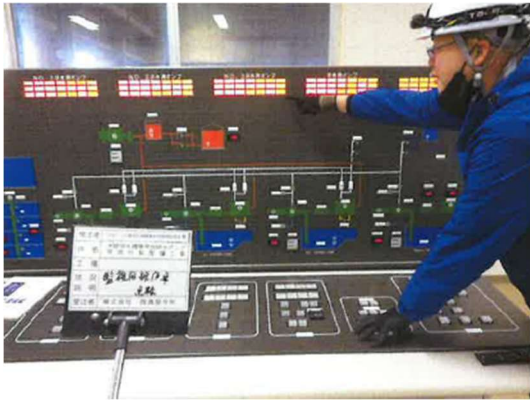
写真：本郷排水機（電気設備 監視操作 卓の点検）（大空町提供）
