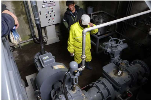
写真：揚水機の設備点検 (浦臼土地改良区提供)
