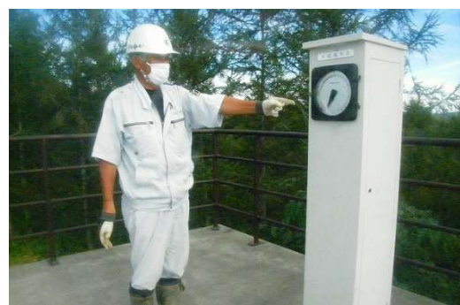
写真：水位指示計の確認 （雨竜土地改良区提供）
