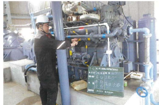
写真：排水機のポンプ設備点検 (浦臼町提供)
