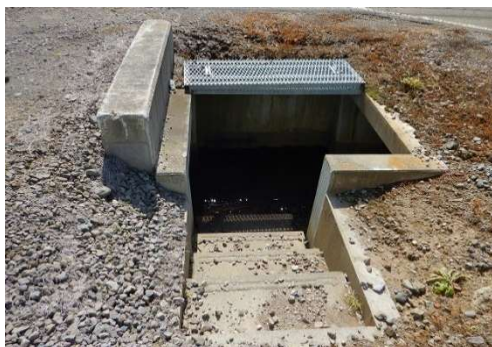
写真：生活（防火）用水施設 （令和7年9月撮影）
