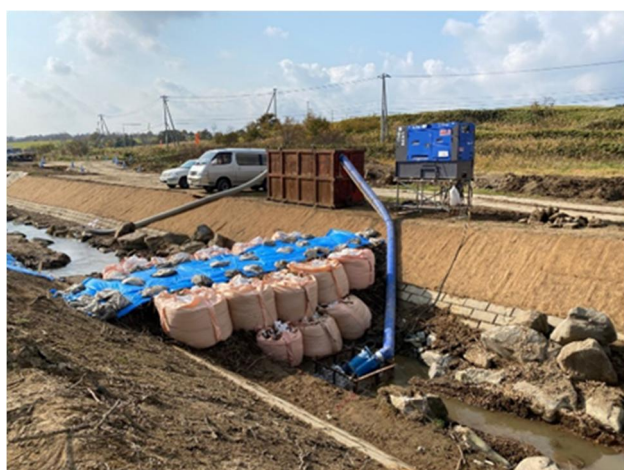
排水路施工時の濁水処理施設 (令和5年10月撮影)
