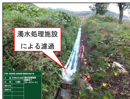
濁水処理施設の設置状況 (令和7年10月撮影)
