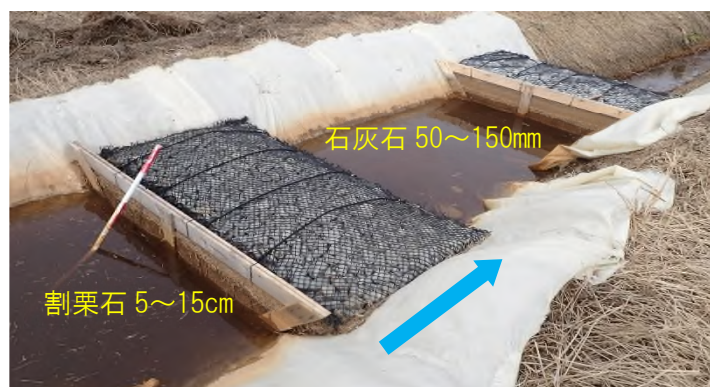
濁水処理施設の設置図 (平成 29 年度撮影)
