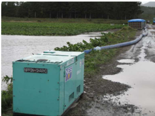
写真：ポンプによる湛水排除 (出典：事業計画時参考資料)
