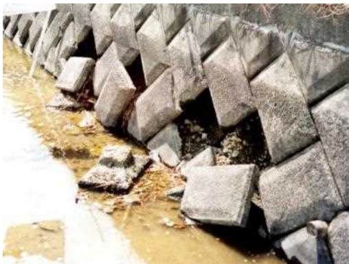
写真：老朽化した共栄幹線用水路 （大雪土地改良区からの提供）
