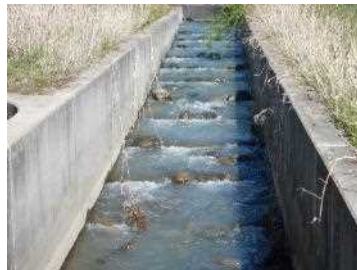
写真：頭首工に設置された魚道 (令和2年5月撮影)
