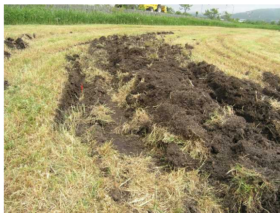
地耐力不足状況 (H22年頃撮影)
