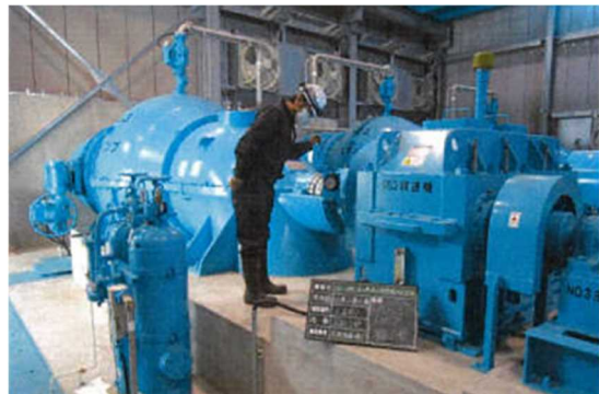
写真：主ポンプ(No. 1~3)運転点検 (池田町からの提供)
