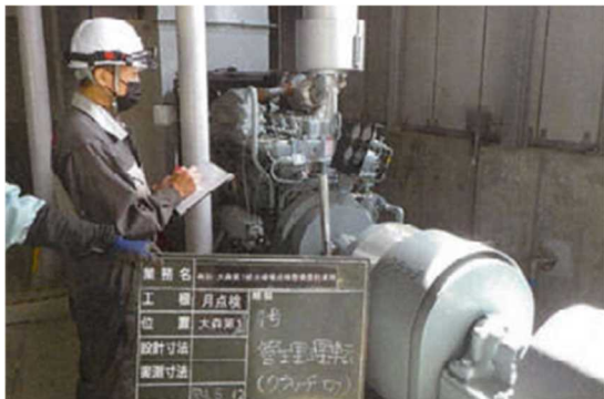
写真：主電動機運転確認 (池田町からの提供)
