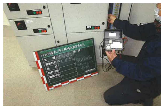
写真：電気設備点検 (本別町からの提供)
