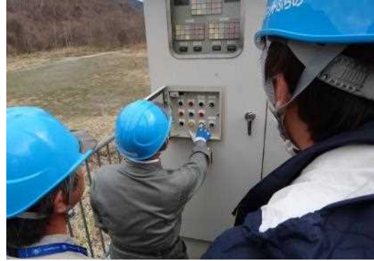
写真：電気設備点検 (富良野土地改良区からの提供)
