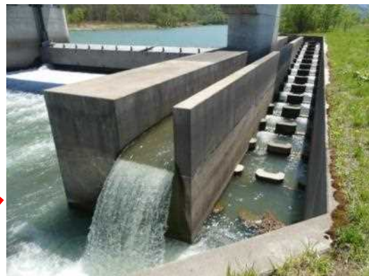
写真：空知川頭首工に設置された魚道 (令和4年5月撮影)
