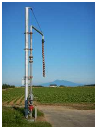
写真：多目的給水栓 (平成 28 年 7 月 25 日撮影)
