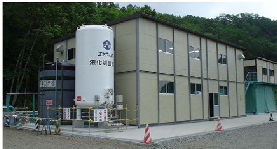
堤体建設に伴う濁水処理設備 (H22 年撮影)
