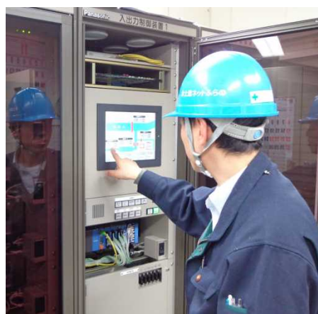
写真：布部川頭首工 操作盤点検状況 (富良野土地改良区提供)
