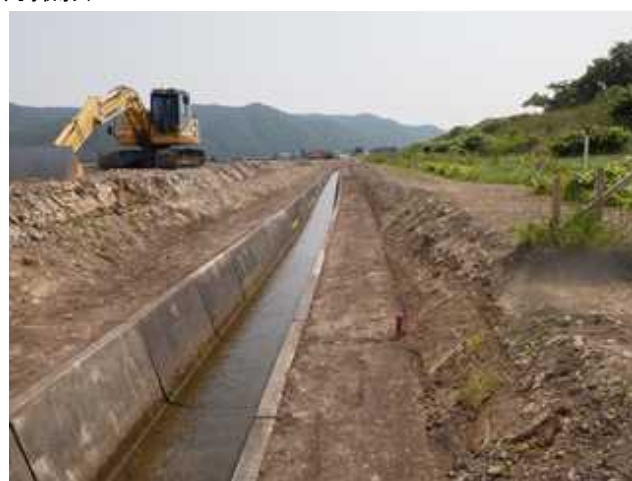
既設材料の使用水路：V1000 フリーム
